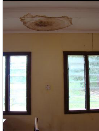
Wasserschaden an der Decke
